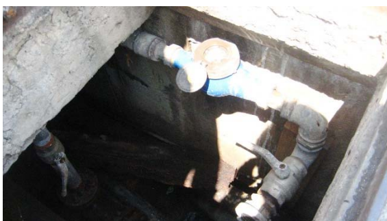
Slika 11 Vodovodni priključek za ladje (2)
