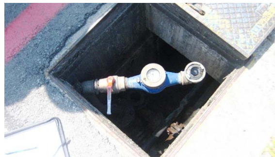
Slika 10 Vodovodni priključek za ladje (1)
