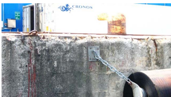
Slika 3 Poškodbe roba pomola
