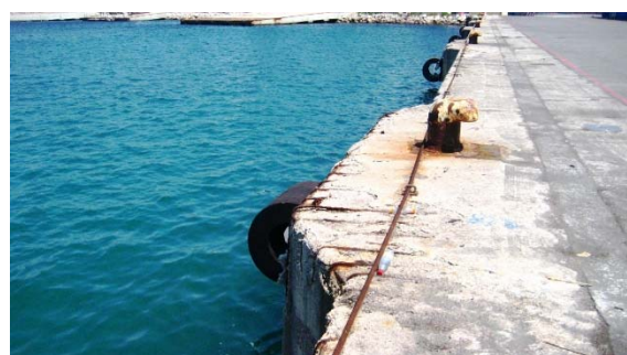
Slika 6 Poškodbe horizontalne površine pomola
