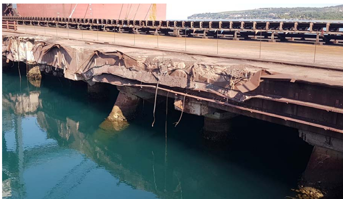
Slika 1,2 – Poškodba kabelske trase na obali TRT1 zaradi padca dvigala
