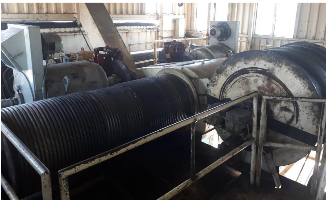
Slika 2: Strojnica dvigala KD51
