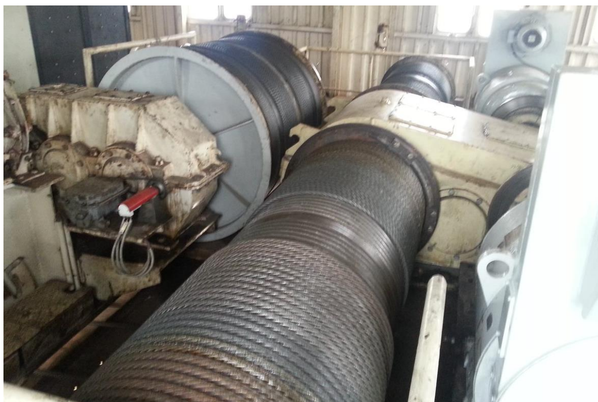
Slika 3: Strojnica dvigala KD51
