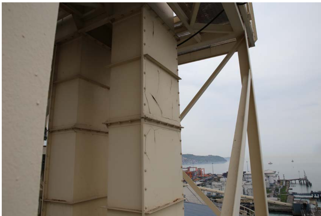
Slika 8 – elevator zgornji del (luščenje barve).
