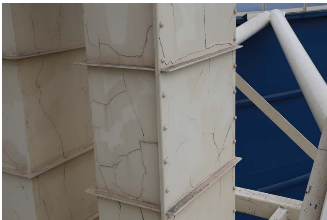
Slika 6 – elevator na višini silosa (razpokana barva).
