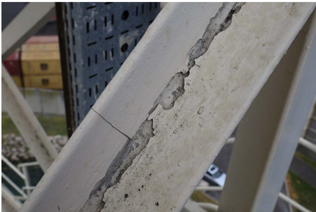
Slika 22 – luščenje barve na diagonalah paličja.
