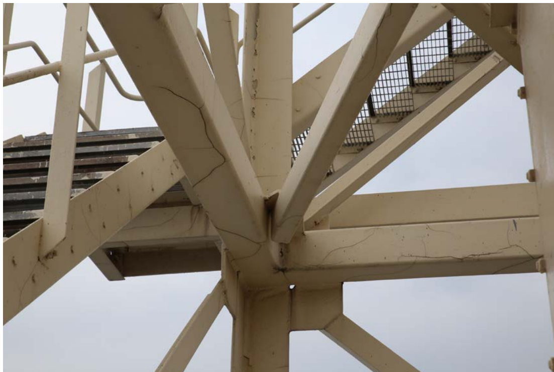
Slika 23 – detajl vozlišča (razpoke in luščenje barve).
