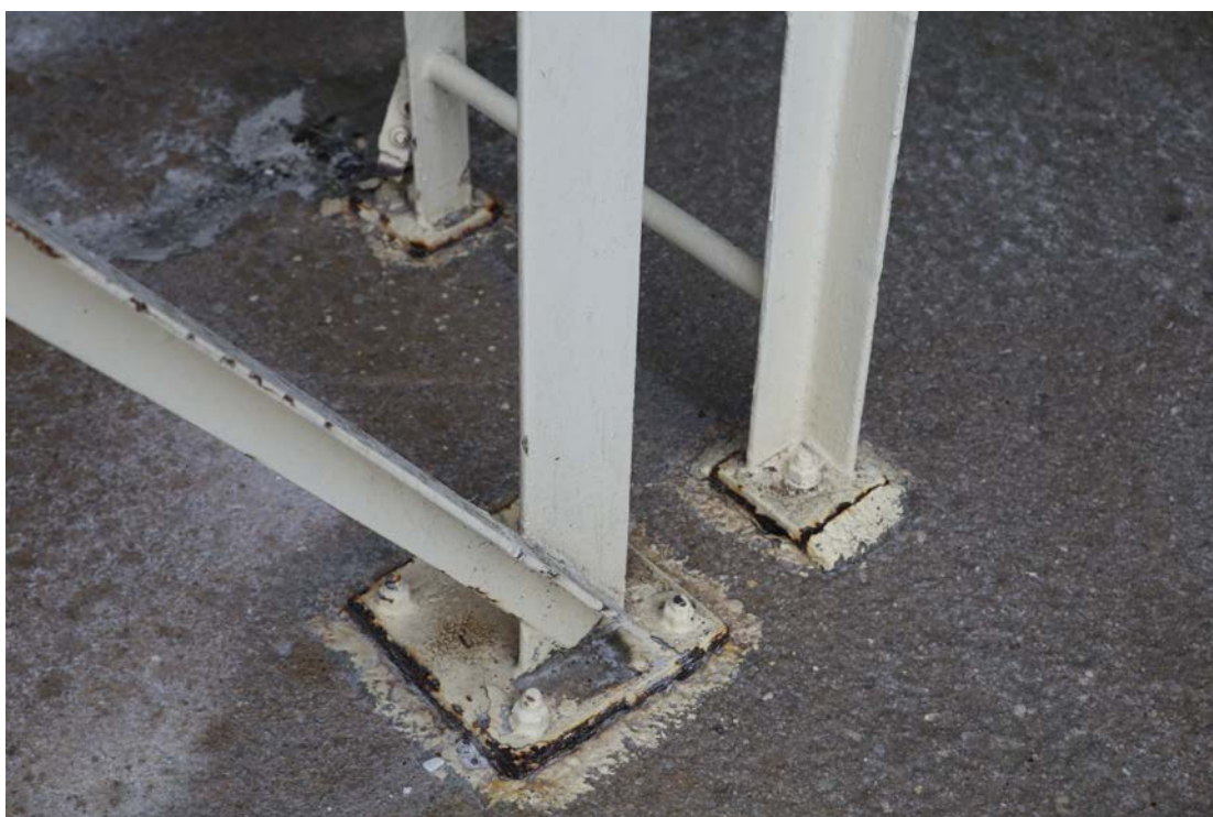
Slika 4 – sidrišča stebrov stolpa elevatorja (koroziija).
