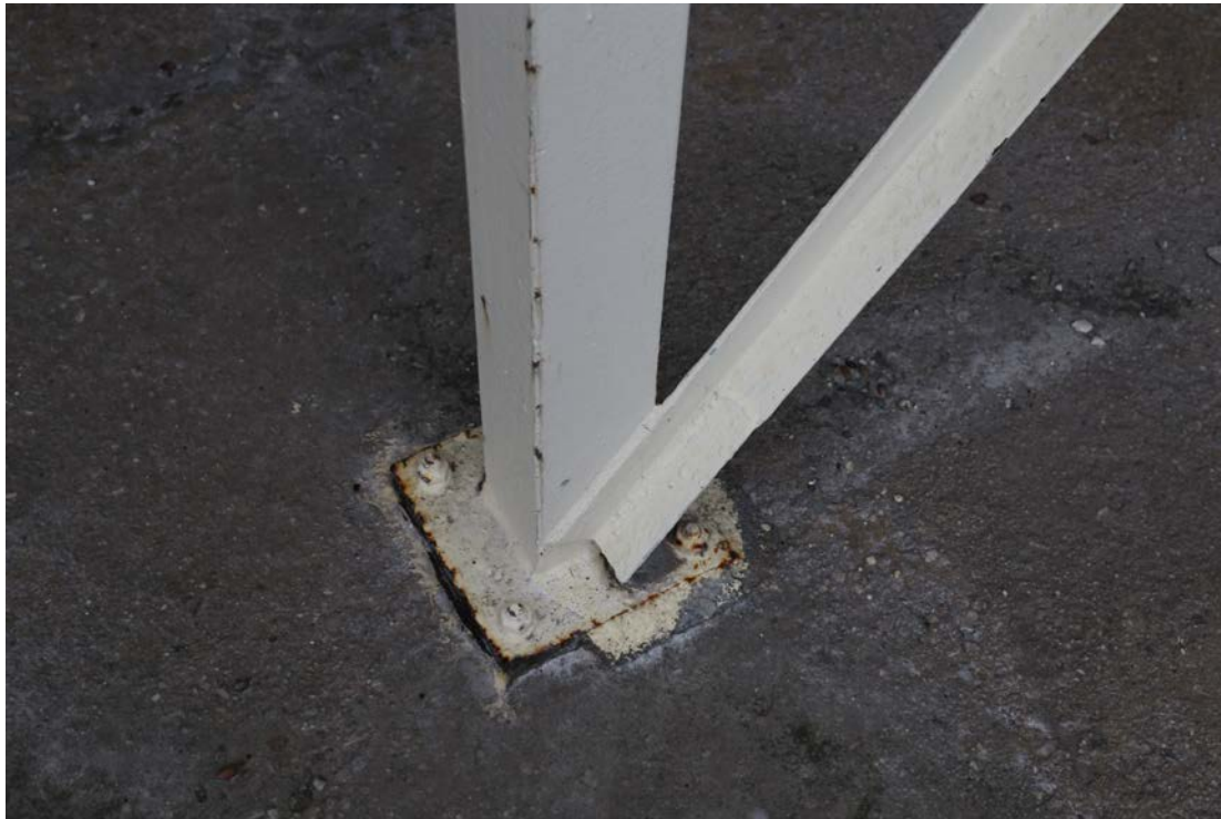
Slika 3 – sidrišča stebrov stolpa elevatorja (koroziija).
