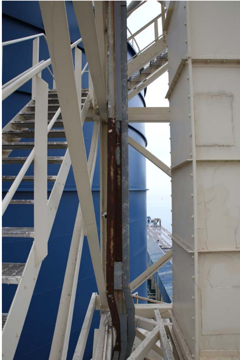
Slika 32 – instalacije ob vogalu večjega elevatorja.
