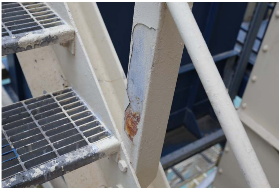
Slika 12 – luščenje barve stopnišne ograje.
