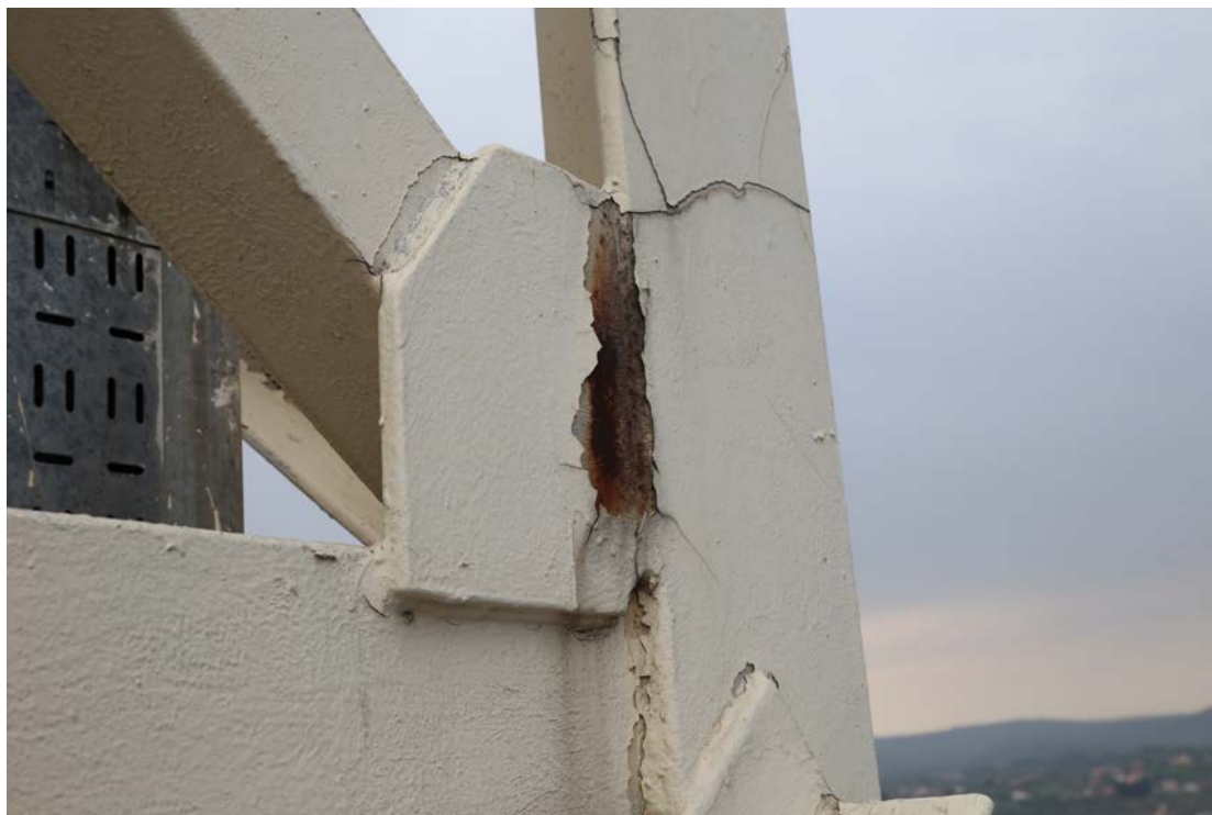
Slika 25 – korozija priključnih pločevin v vozlišču paličja.
