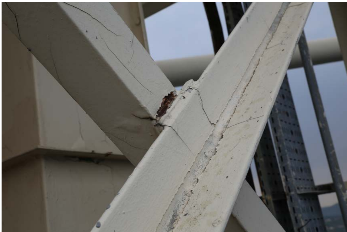
Slika 25 – poškodbe barve in korozija na diagonalah paličja.
