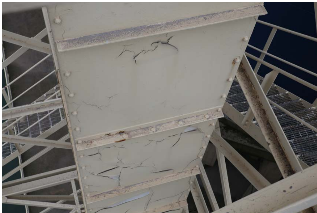
Slika 7 – elevator (luščenje barve).
