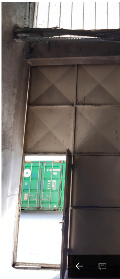
Slika 5: Obstoječe stanje – skladišče 30 C
