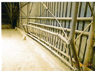
horizontalni nosilec in diagonalni vezi - deformirano
