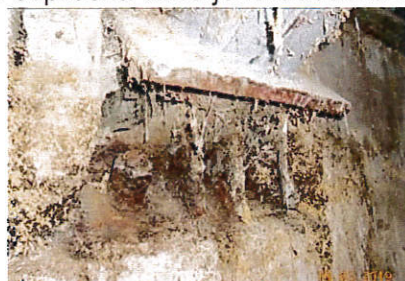
korozija na sidrišču
