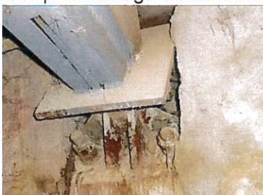
korozija na sidrišču
