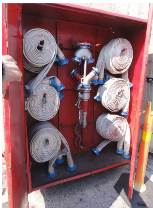
Slika 5: Oprema v hidrantni omarici
