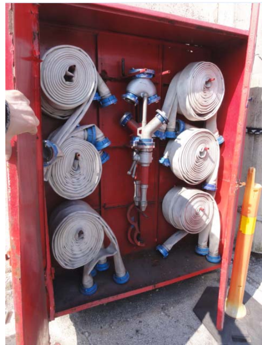
Slika 5: Oprema v hidrantni omarici
