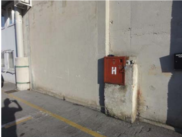
Slika 2: zunanji hidrant ob cesti 1 (morska stran)
