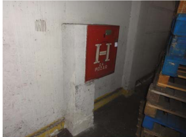
Slika 3: notranji hidrant v skladišču
