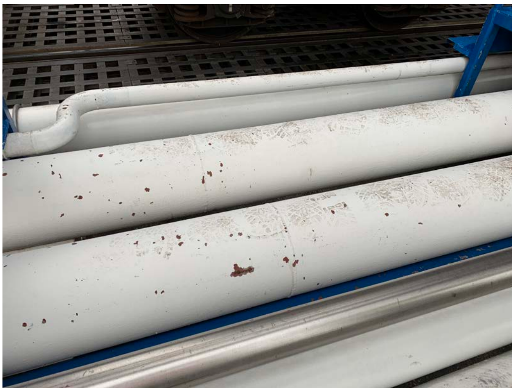
Slika 21 – cevovod na vagonski polnilnici.
