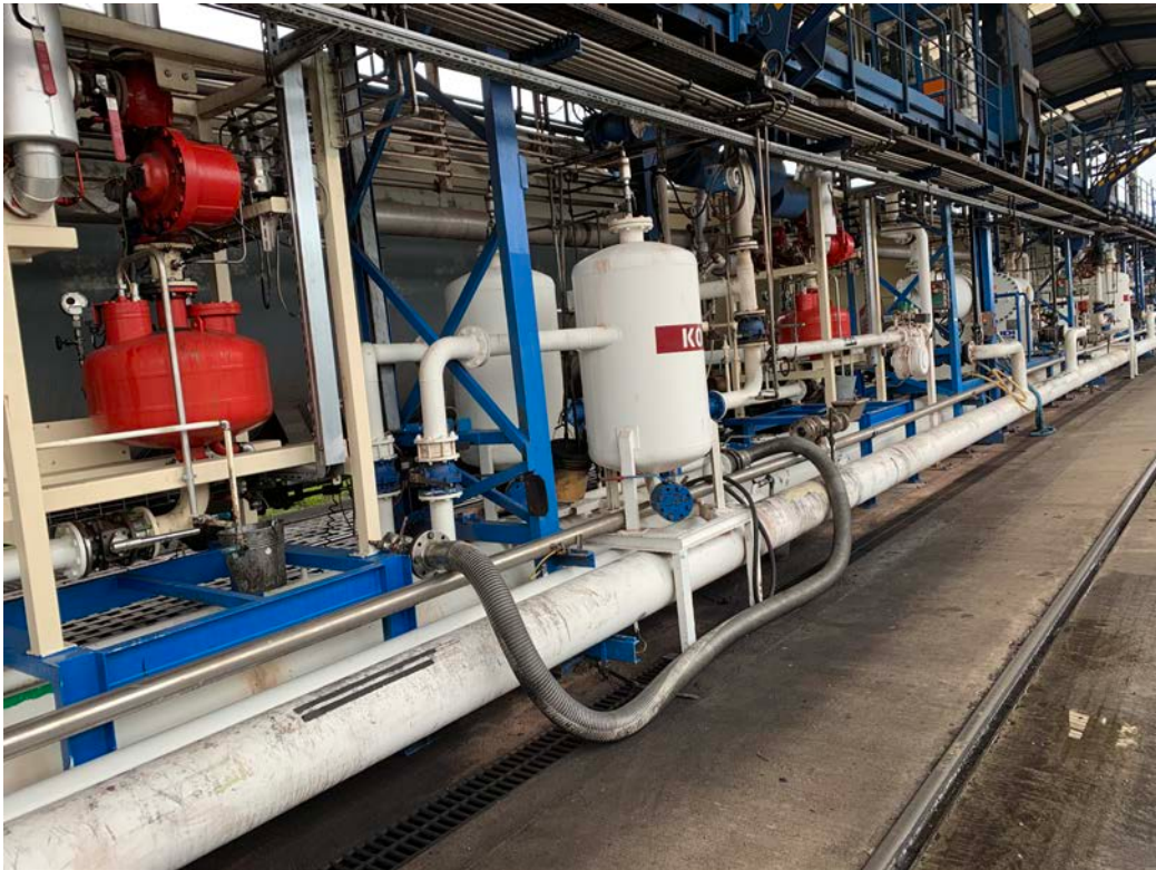
Slika 27 – instalacije in cevovod.
