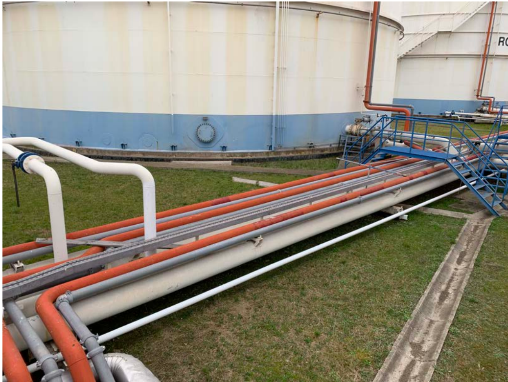
Slika 5 – cevovod med rezervoarji.
