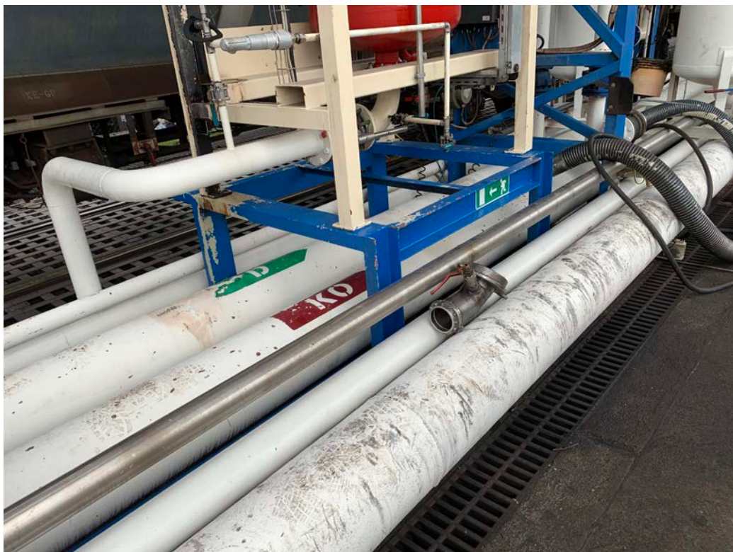
Slika 22 – cevovod in druge instalacije vagonске polnilnice.
