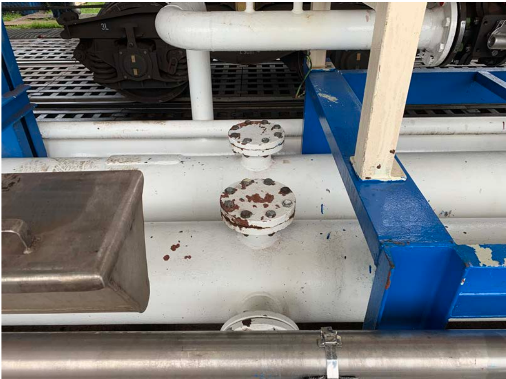
Slika 28 – cevovod, oprema in podkonstrukcija instalacij.
