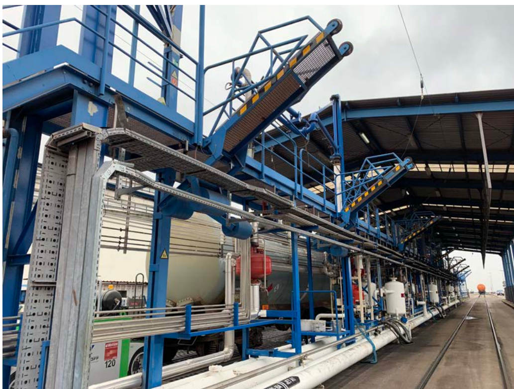
Slika 20 – inštalacijski podest vagonške polnilnice.
