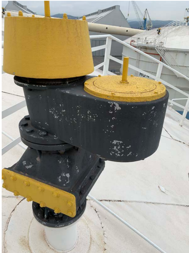
Slika 16 – oprema na strehi.
