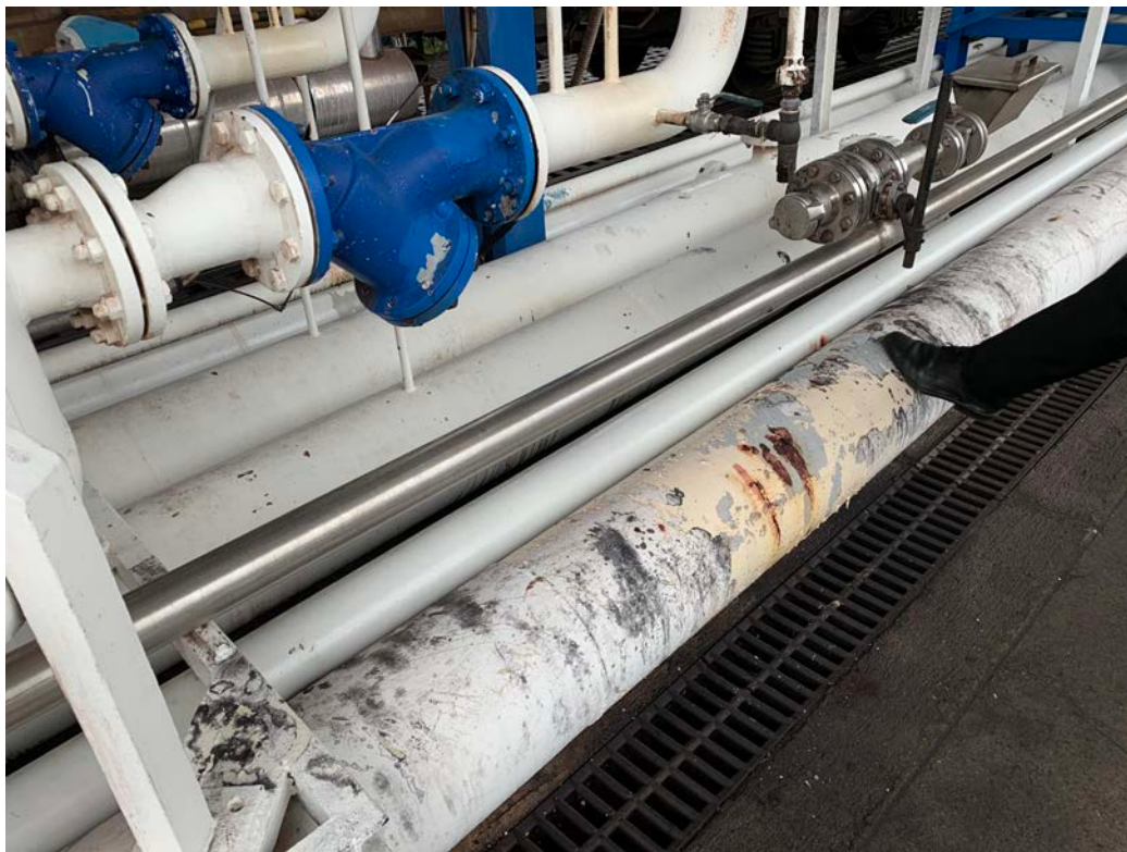
Slika 25 – cevovod (poškodbe cevi na tirni strani).
