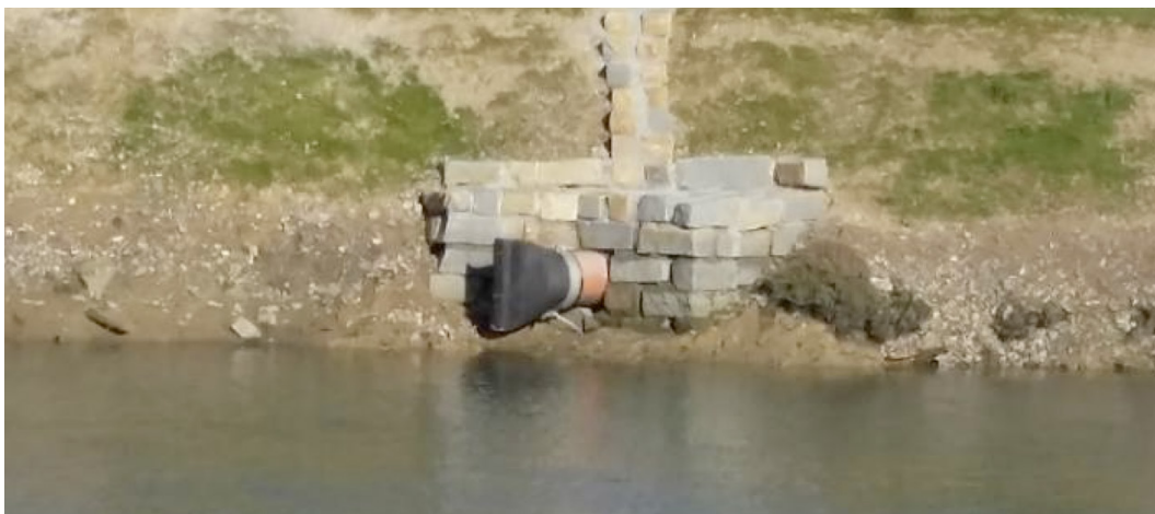
Slika 40: Sistem, ki preprečuje vdor narasle morske vode v sistem meteorne kanalizacije.
