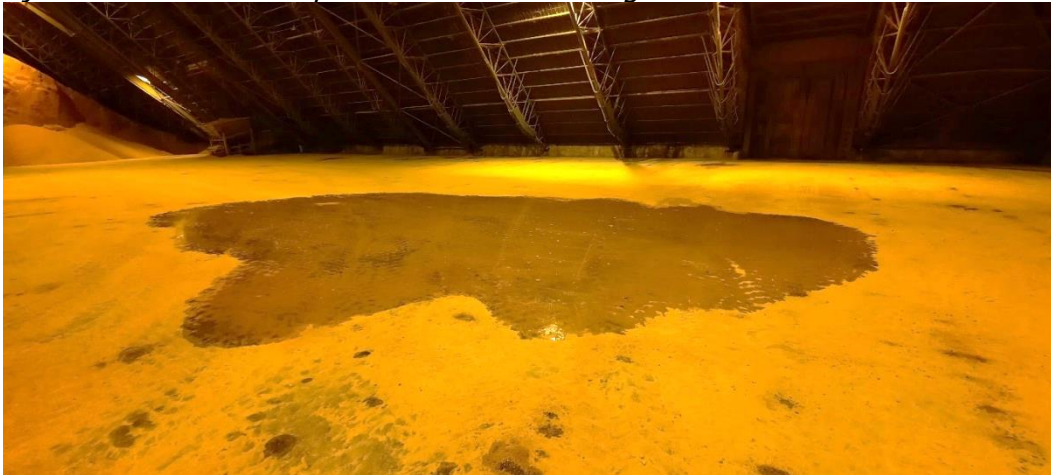
Slika 2. Posedeno območje z neustrezno ureditvijo tlaka ob vhodu v skladišče povzroča vdiranje in zastoje meteornih voda ter posledično škodo na blagu.
