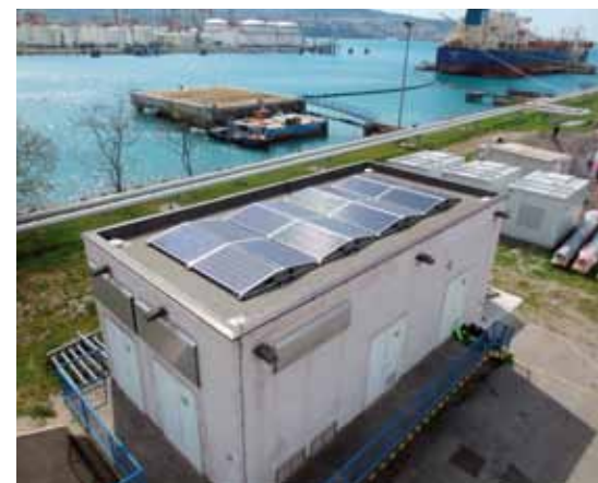
Ena od treh luških mikro sončnih elektrarn, ki bodo kmalu pričele loviti sončne žarke in jih pretvarjati v elektriko za potrebe sicer velikega porabnika - pristanišča.
