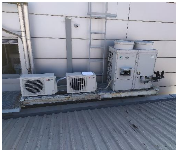
Slika 8: Obstoječa toplotna črpalka Daikin
