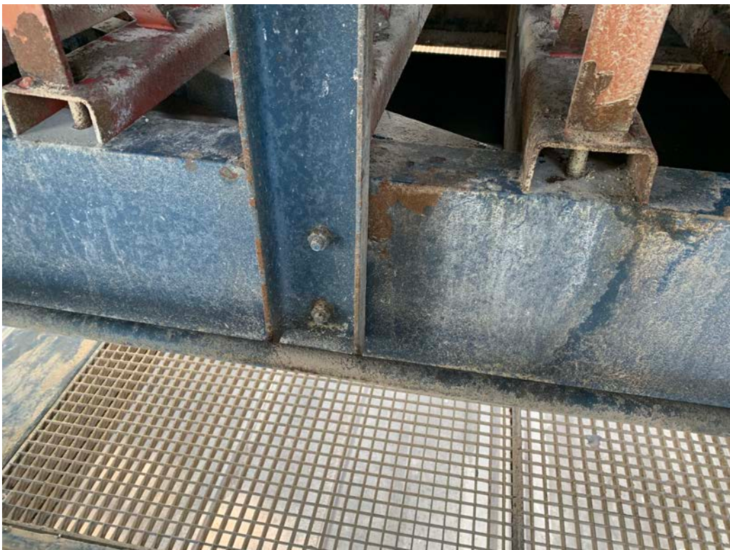
Slika 14 – poškodbe nosilca transportnih trakov.
