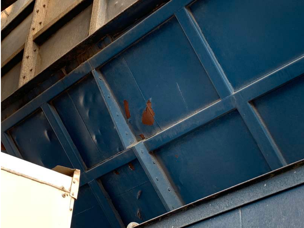
Slika 7 – korozijske poškodbe na bunkerju.
