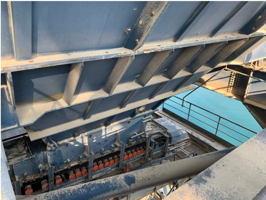
Slika 8 – poškodbe na ojačitvenih rebrih bunkerja.
