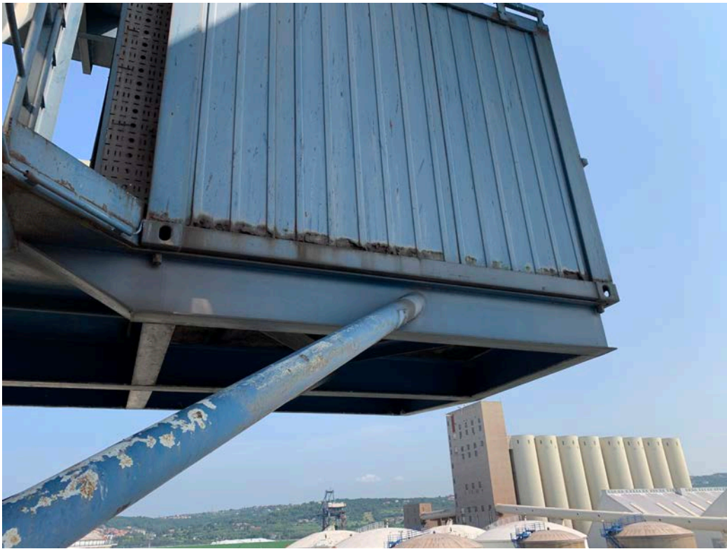
Slika 7 – dotrajani paneli prostora strojnice.
