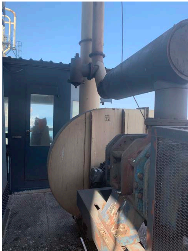
Slika 8 – inštalacije cevodov za odpraševanje (se odstranijo).
