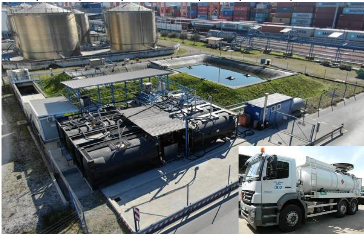
Slika 3: Objekt za zbiranje kalužnih olj ter kamion cisterna za prevzem ladijskih kalužnih olj
