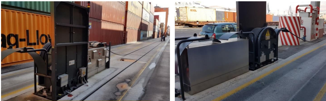
Slika 14: APS priklopno mesto za E-RTG dvigalo
