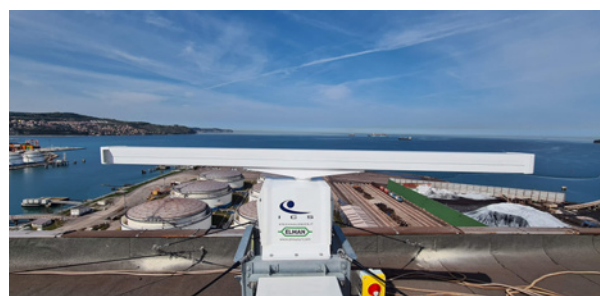
Radar za zaznavanje onesnaženj na morju, nameščen na strehi silosa v Luki Koper.
