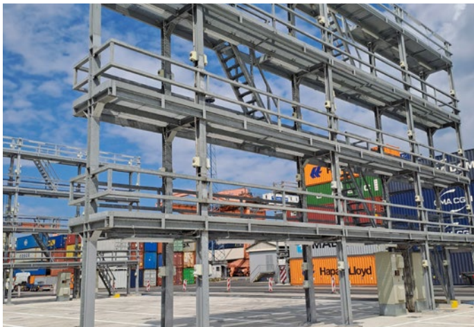
... do letos pa smo galerije dvignili za dve višini in dokončno uredili sodobne visokozmogljive frigo galerije.
