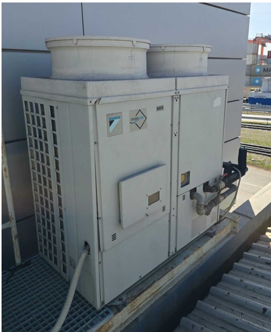
Slika 2: Obstoječa toplotna črpalka
