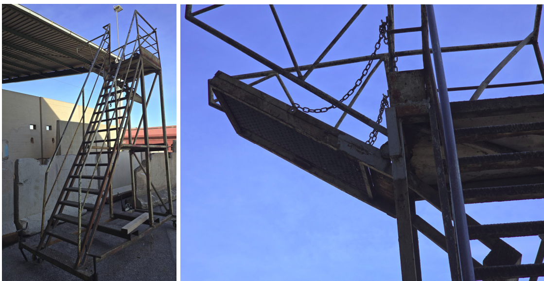
Slika 2: Obstoječ podest za dostop do streh vagonov
