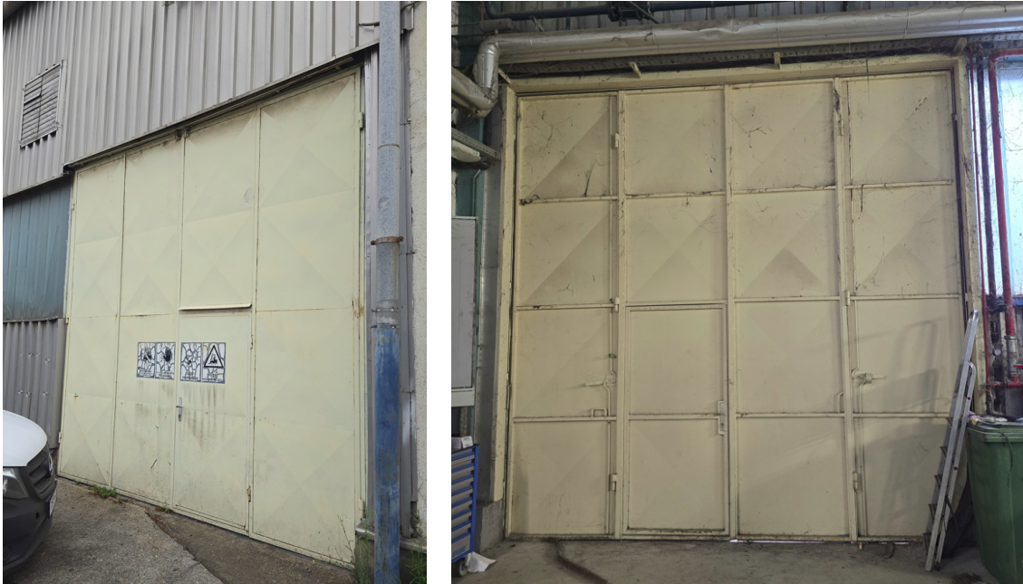
Slika 2: Obstoječa kovinska vrata (pogled od zunaj in znotraj)
