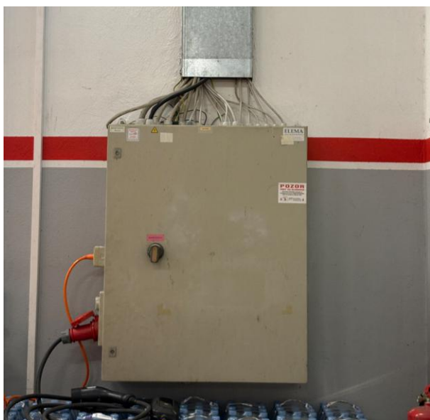
SLIKA 3: OBSTOJEČA ELEKTRO OMARA.
