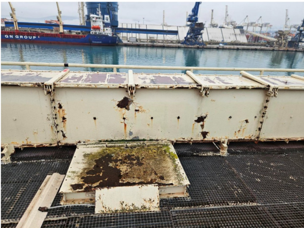
Slika 4. Prikaz stanja konstrukcije verižnega transporterja
